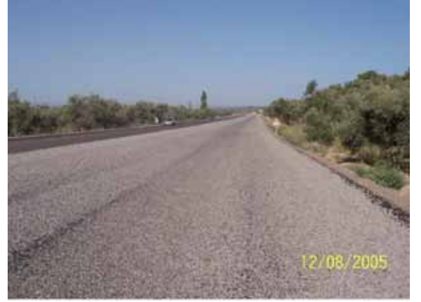
Şekil 4 Kaplamadan sonra yolda bırakılmış serbest mıcır
