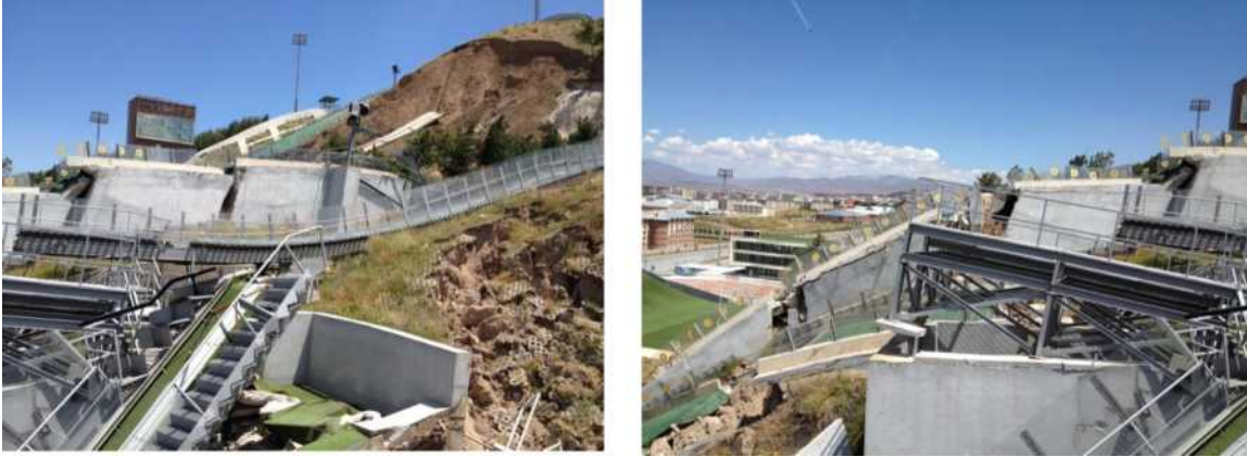
Şekil 3. İniş rampalarında meydana gelen yapısal hasarlara örnekler
