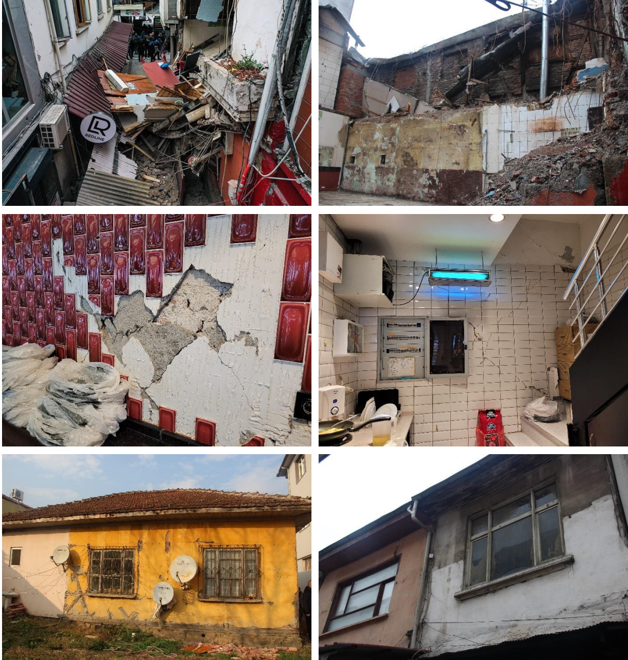
Şekil 12: Yığma binalarda yapısal hasar örnekleri
