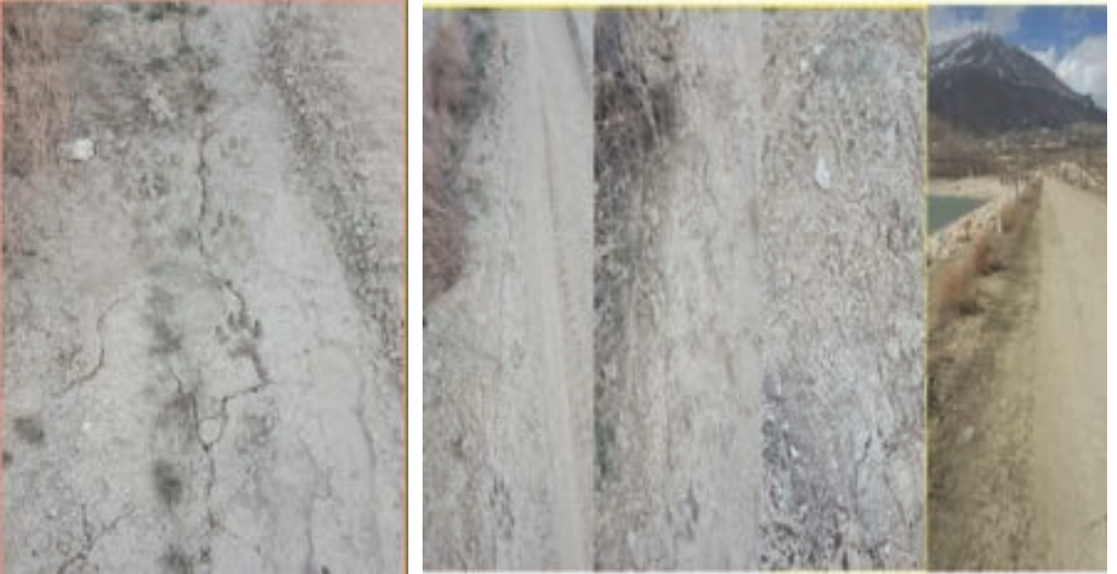
Şekil 20- Polat Barajı kretinde oluşan kılcal çatlaklar (sol)
