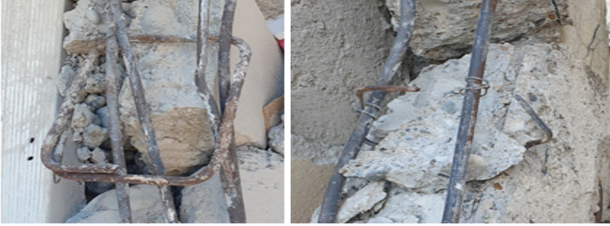
Yıkılan binalardaki etriyelerin büküm şekilleri (Osmaniye)
