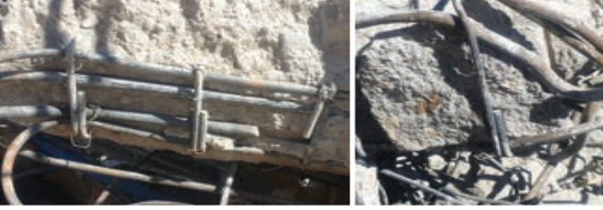
Yıkılan binalardaki etriyelerin büküm şekilleri (Besni)
