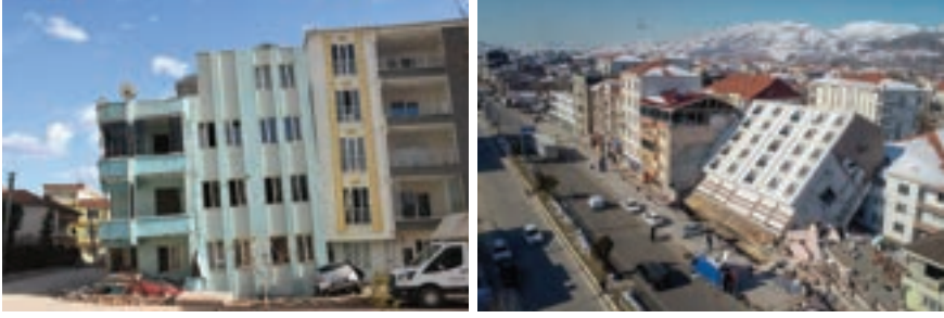
Şekil 43. Zemin sıvılaşması nedeniyle hasar almış binalar
