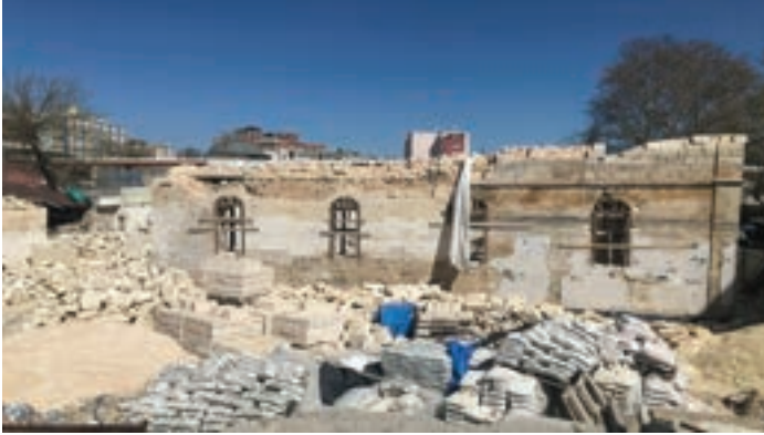
Adiyaman Çarşı Cami güney cephesinde kaplaması dökülen yeni duvar örgüsü
