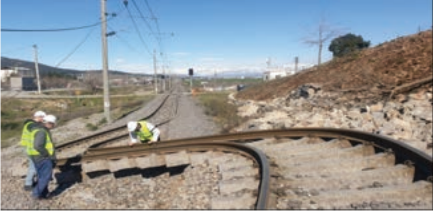
Şekil 70 – Hasar gören tren rayları 3 (Türkoğlu, Kahramanmaraş)
