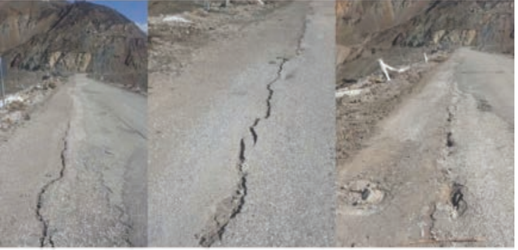
Şekil 12- Çat Barajı kretindeki sistematik çatlaklar
