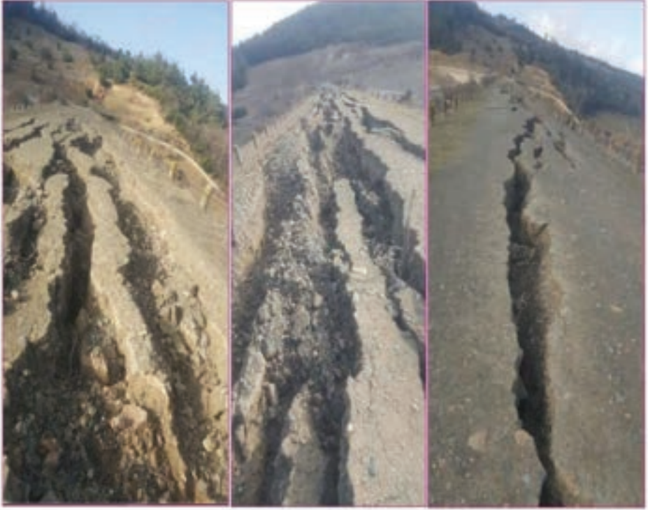
Şekil 29- Arıklıkaş baraj kretinde derin çatlaklar (ađır hasar)
