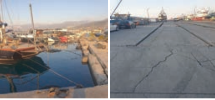
Şekil 5: İskenderun Balıkçı Barınağındaki yapısal hasarlar
