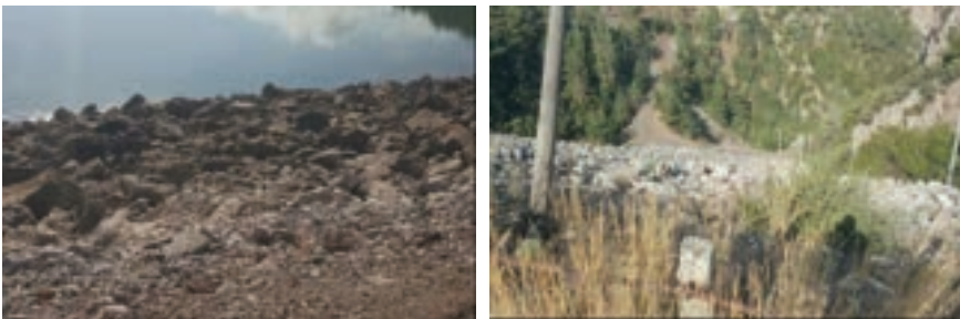
Şekil 34- Kalecik baraj gövdesi memba şevindeki deformasyon (sol)
