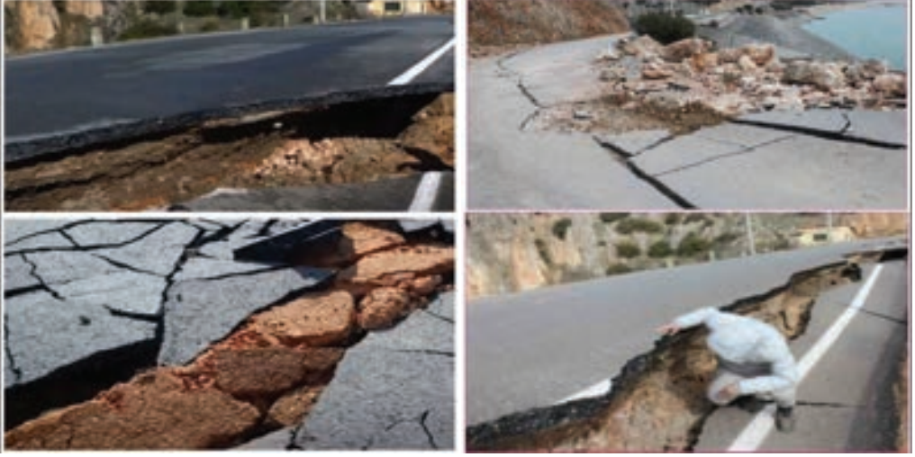
Şekil 6- Kartalkaya barajı gövdesindeki tipik hasarlar
