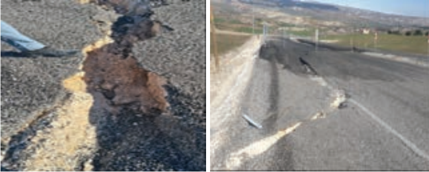
Şekil 71 – Adıyaman-Besni arasındaki yol göçmeleri 1
