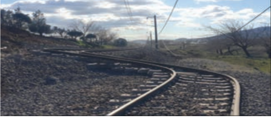
Şekil 69 – Hasar gören tren rayları 2 (Türkoğlu, Kahramanmaraş)
