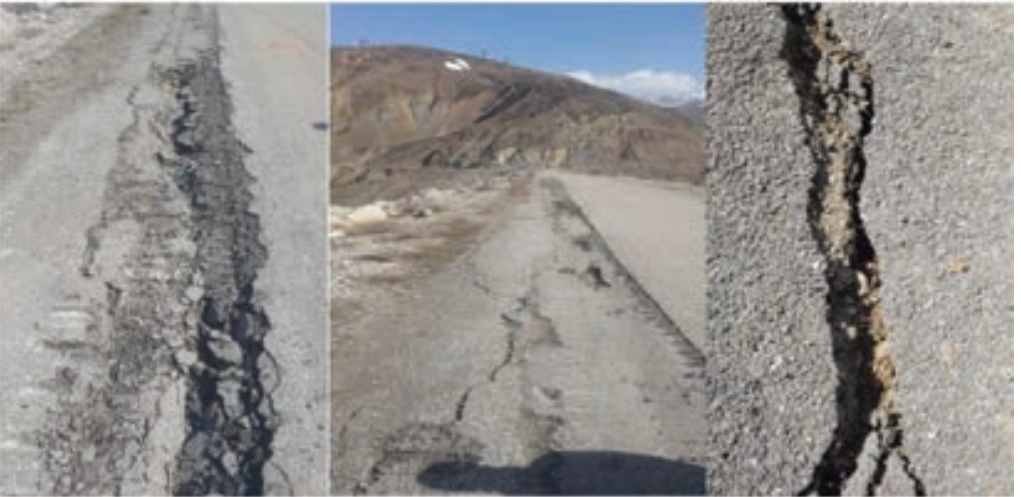
Şekil 13- Çat Barajı kretindeki sistematik çatlaklar ve yanıl yayılmalar
