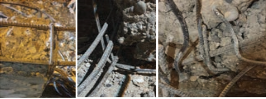
Yıkılan binalardaki etriyelerin büküm şekilleri (Adana)
