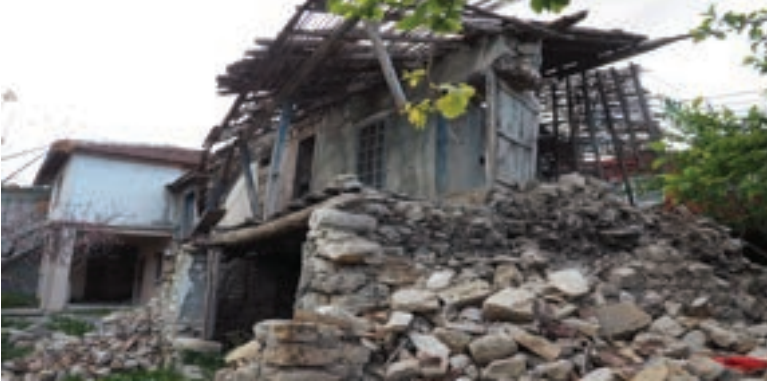
Hatay, Samandağ İlçesi, Hıdırlı Köyü, yıkılmış taş yapı
