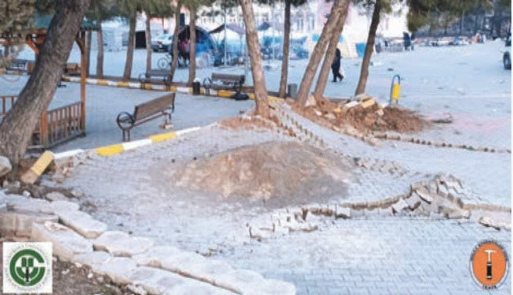
Şekil 12i: Yunus Emre Ortaokulu girişinde yüzey yırtılması izleri. Konum için Şekil 12f'ye bakınız.
