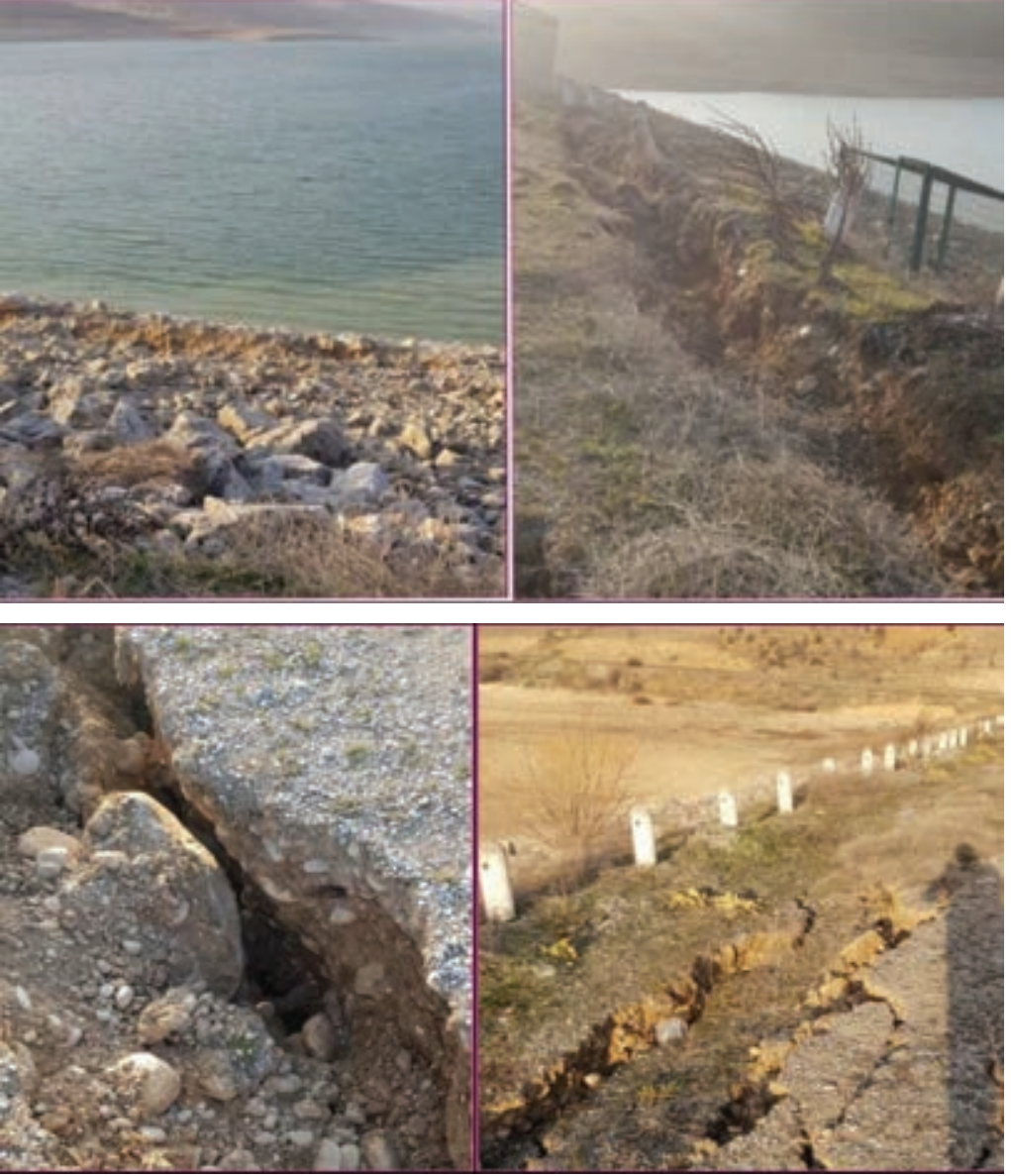
Şekil 4- Memba şevinde yanıl yayılma, kayma ve çekme çatlağı
