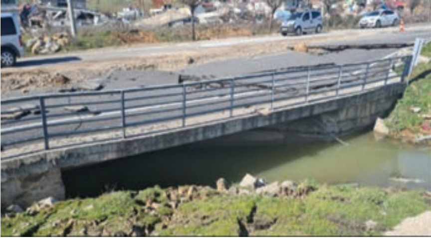
Şekil 73 – Nurdağı-Kahramanmaraş karayolundaki köprü çökmesi
