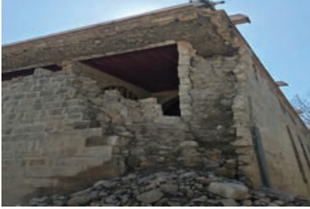
Adıyaman Mor Petrus ve Mor Paulus Kilisesi kuzeydoğu köşesinde hasarlar
