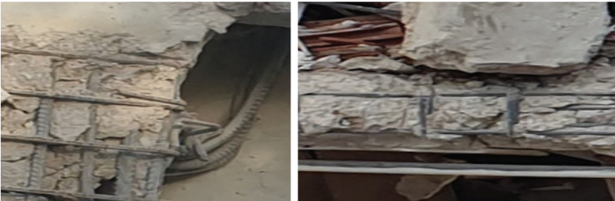
Yıkılan binalardaki etriyelerin büküm şekilleri (Antakya)
