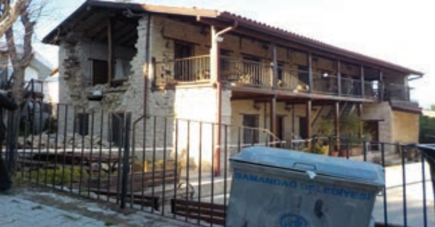
Hatay, Samandağ İlçesi Vakıflı Köyü restore edilmiş yapının yan duvarı yıkılmış
