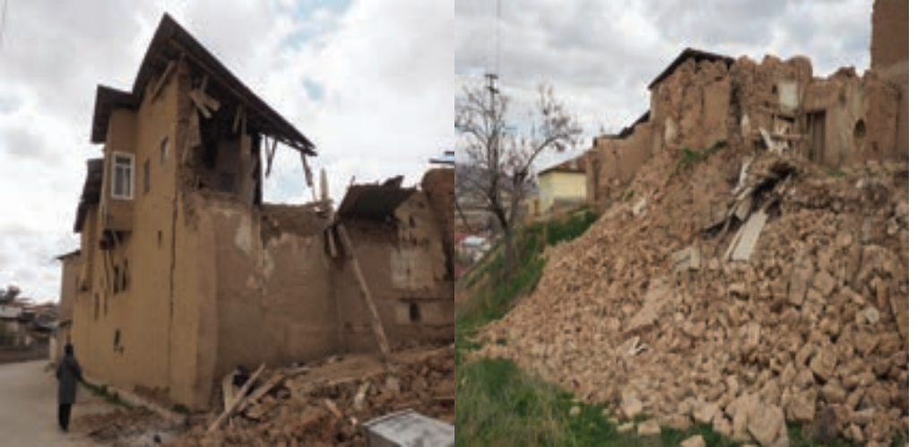
Balaban 2023 Deprem sonrası yıkılmış yapılar
