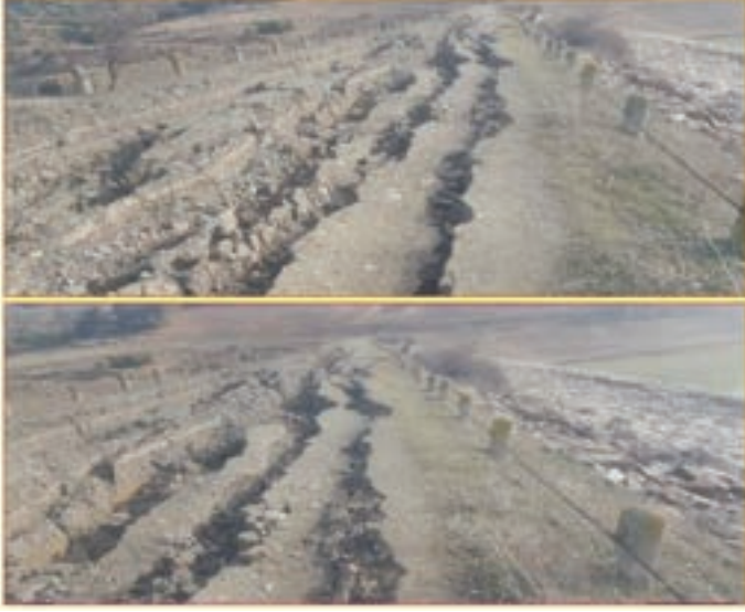
Şekil 28- Arıklıkaş baraj kretindeki derin çatlaklardan detaylı görüntü
