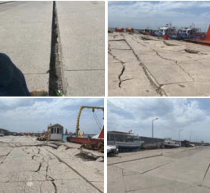
Şekil 6: Dört Yol Balıkçı Barınağı rıhtım bloklarında gözlemlenen yapısal hasarlar
