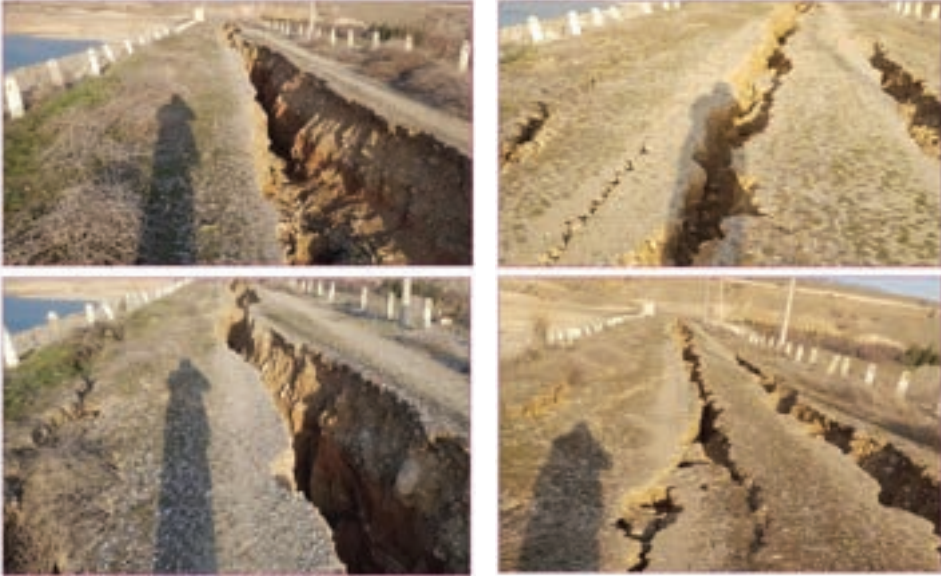
Şekil 3- Sultansuyu barajının depremden 10 gün sonraki görüntüleri
