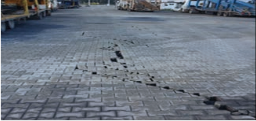
Şekil 67 – İskenderun Limanında Tır park alanı zeminindeki çatlaklar
