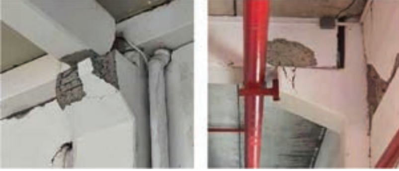
Kısa Konsol Hasarı
