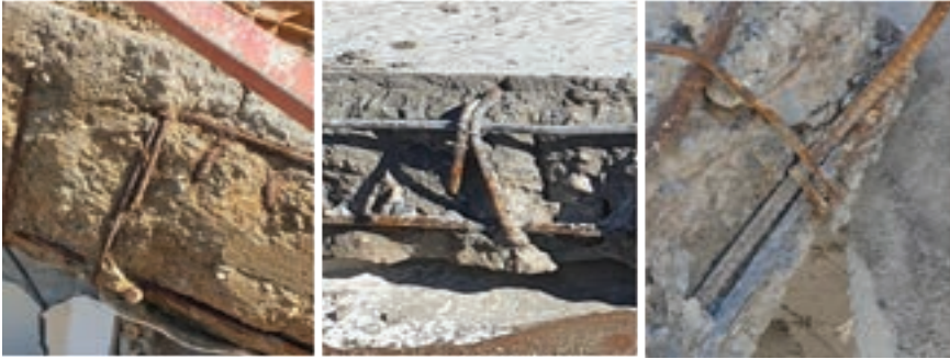
Yıkılan binalardaki etriyelerin büküm şekilleri (Adana)
