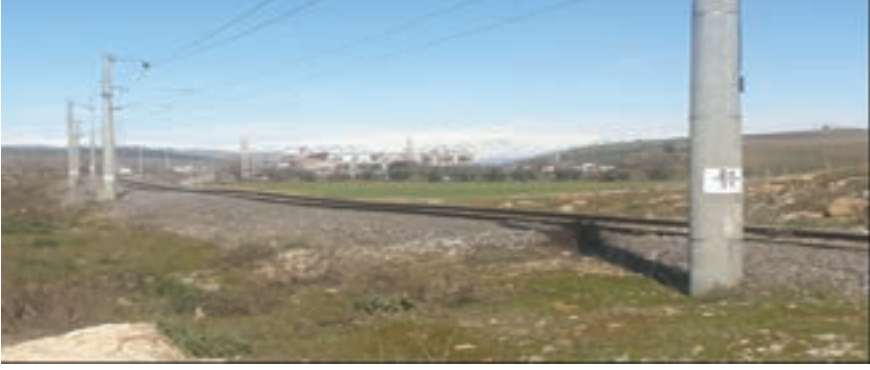
Şekil 68 – Hasar gören tren rayları 1 (Türkoğlu, Kahramanmaraş)
