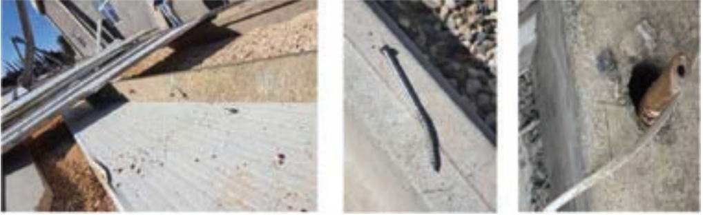
Çatı örtüsünün beton aşıkla yetersiz bağlantısı ve açık uç bağlantısında dolgu harçsız uygulama
