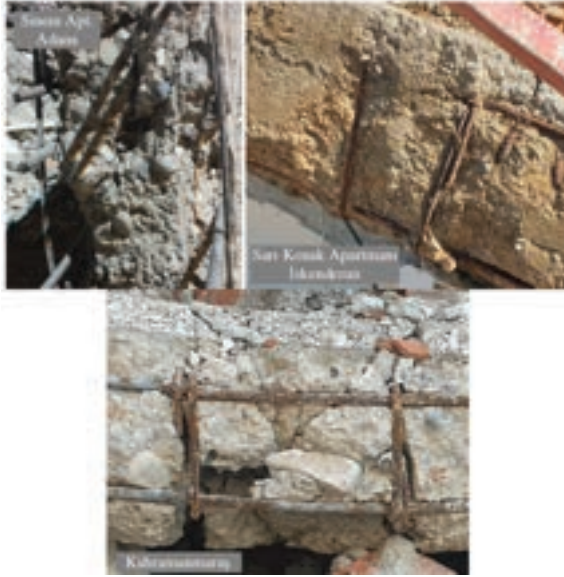
Yıkılan bazı binalarda gözlenen beton kalitesi
