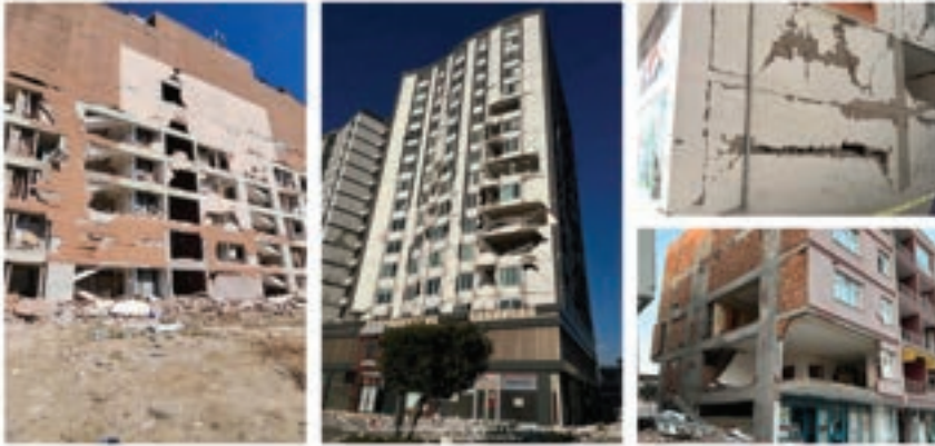
Yapısal olmayan bina hasarlarına örnek
