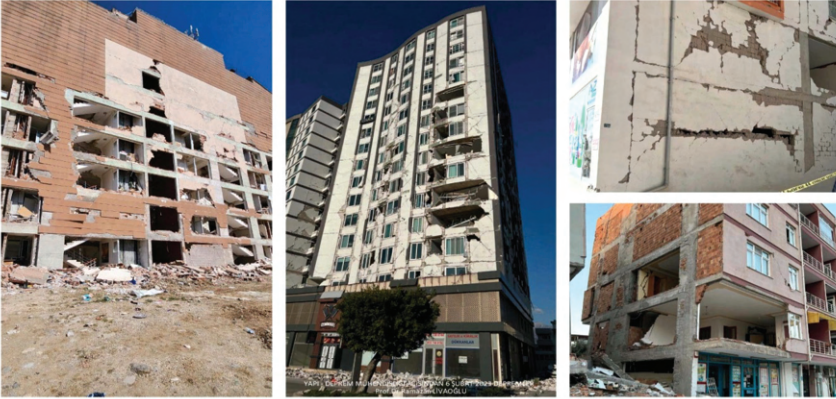
Yapısal olmayan bina hasarlarına örnek
