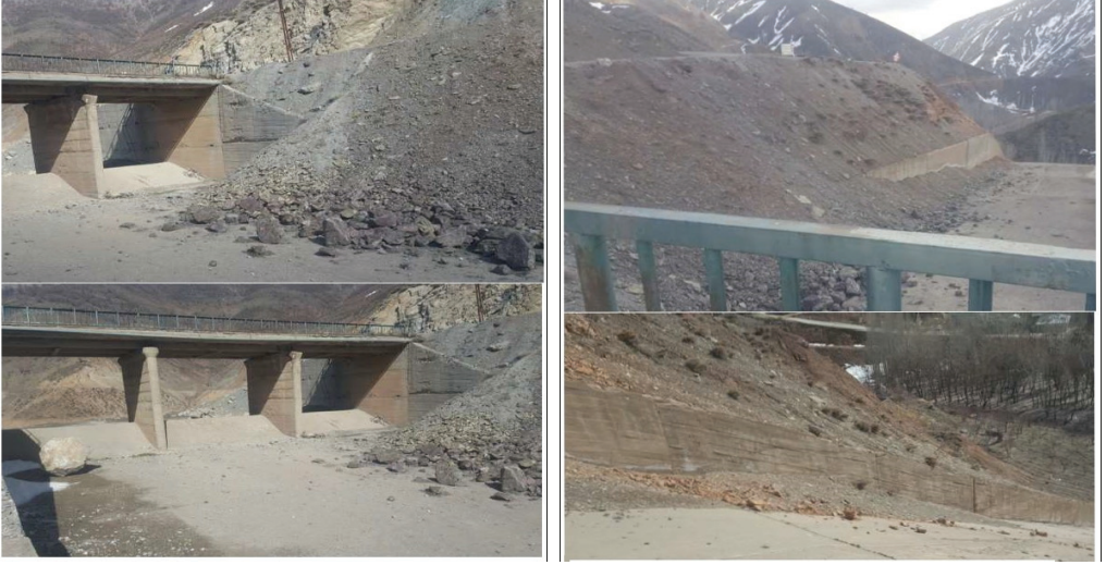
Şekil 17- Dolusavak yapısının olduğu yerde meydana gelen kaya düşmeleri ve moloz akmaları (sol)
