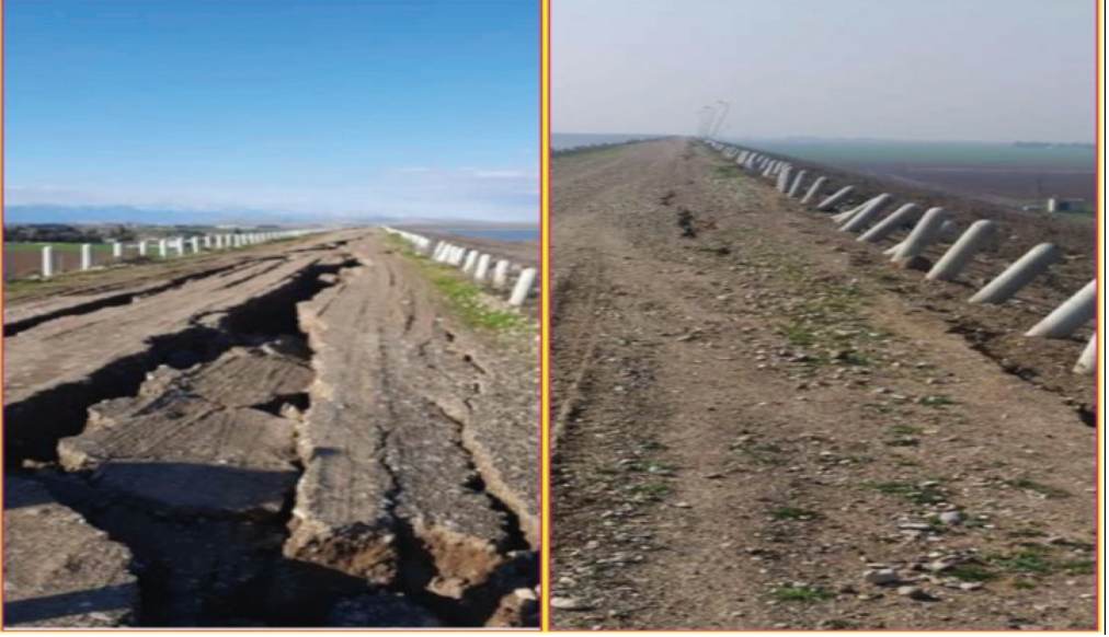
Şekil 42- Reyhanlı Barajı dolgusundan görünümler
