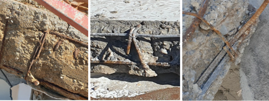
Yıkılan binalardaki etriyelerin büküm şekilleri (Adana)
