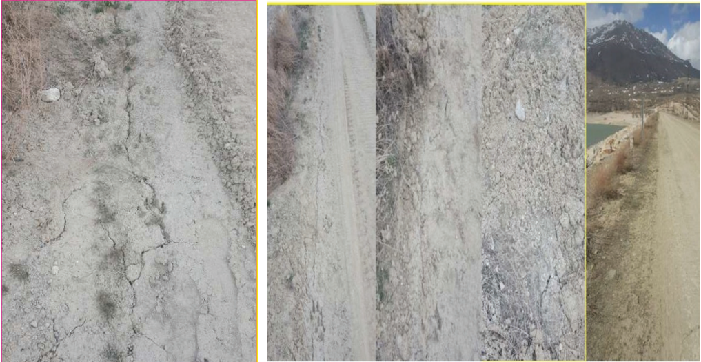
Şekil 20- Polat Barajı kretinde oluşan kılcal çatlaklar (sol)
