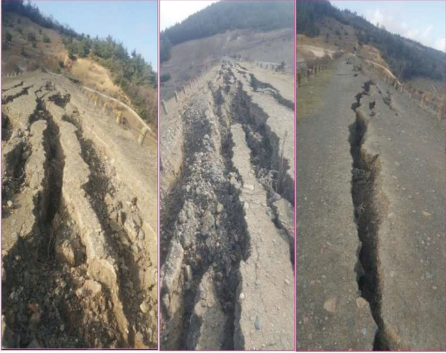
Şekil 29- Arıklıkaş baraj kretinde derin çatlaklar (ağır hasar)
