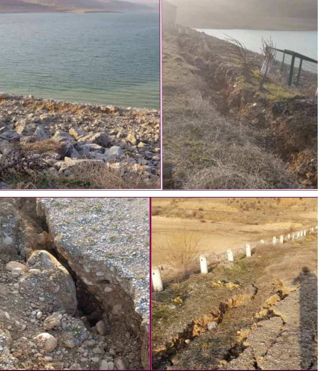
Şekil 4- Mamba şevinde yanıl yayılma, kayma ve çekme çatlağı
