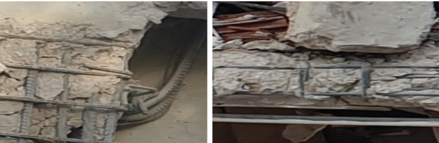
Yıkılan binalardaki etriyelerin büküm şekilleri (Antakya)
