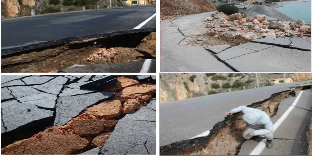
Şekil 6- Kartalkaya barajı gövdesindeki tipik hasarlar
