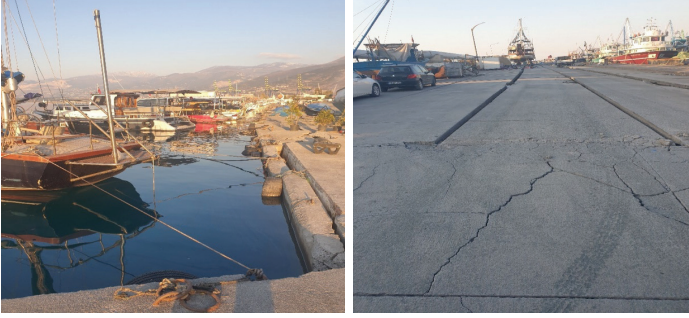
Şekil 5: İskenderun Balıkçı Barınağındaki yapısal hasarlar
