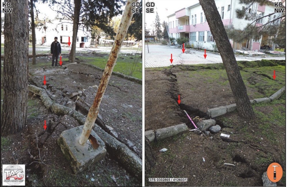
Şekil 12d: Yüzey yırtılmasının Şekeroba İmam Hatip Ortaokulundaki hasar ile ilişkisi. Konumlar için Şekil 12'e bakınız.
