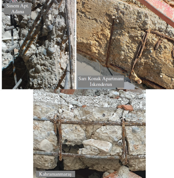
Yıkılan bazı binalarda gözlenen beton kalitesi
