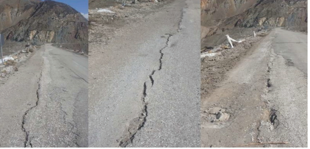
Şekil 12- Çat Barajı kretindeki sistematik çatlaklar
