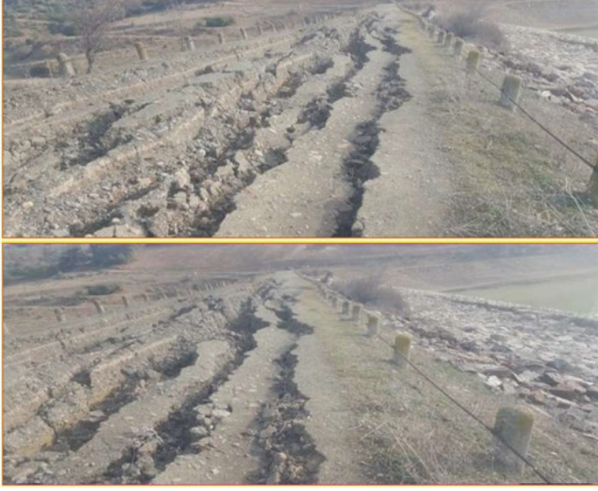
Şekil 28- Arıklıkaş baraj kretindeki derin çatlaklardan detaylı görüntü
