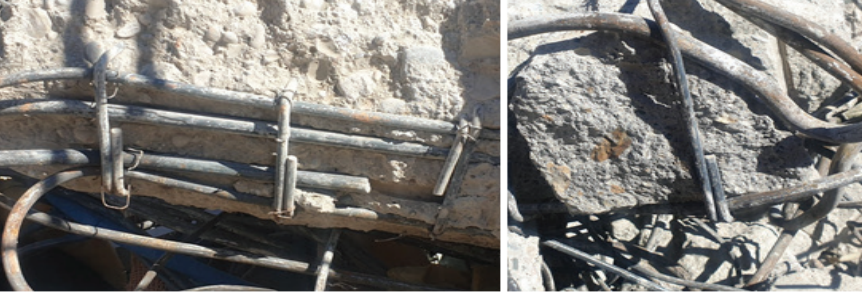
Yıkılan binalardaki etriyelerin büküm şekilleri (Besni)
