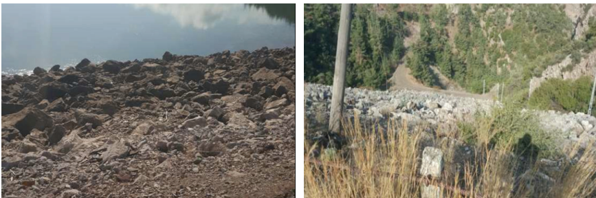
Şekil 34- Kalecik baraj gövdesi memba şevindeki deformasyon (sol)
