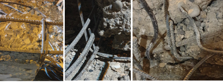
Yıkılan binalardaki etriyelerin büküm şekilleri (Adana)
