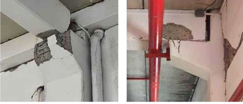
Kısa Konsol Hasarı
